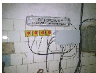
Кнопки аварийной остановки, табло светозвуковой сигнализации, кроссовый шкаф
